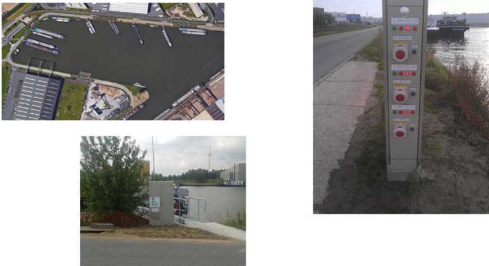
Afb. 4. Walstroominstallaties in de wachthaven van Evergem
