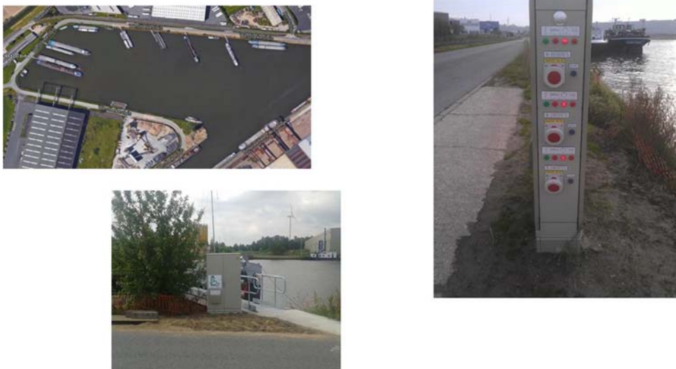
Figure 4. Installations d'alimentation à quai au port d'attente d'Evergem
