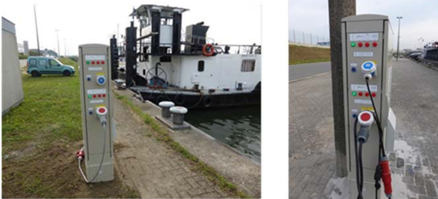
Figure 3. Installation d'alimentation à quai au port d'Anvers
